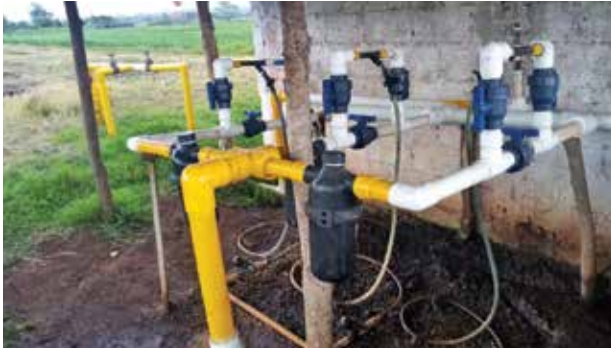
Diagnóstico de sistema de riego y fertirriego en finca La Esmeralda, El Jocotillo, Villa Canales, Guatemala.
