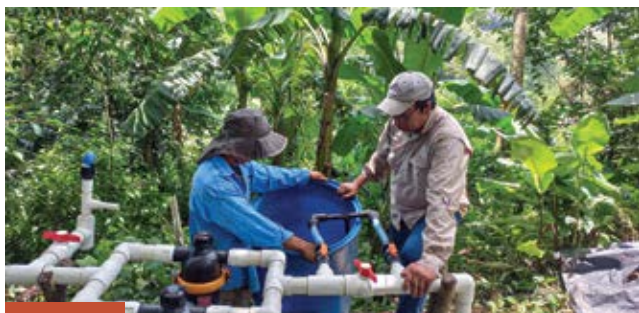
Instalación de venturi para inyección de fertilizantes vía fertirriego.
